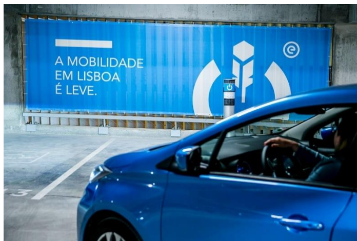
Figura 6-1 Ponto de carregamento Leve
