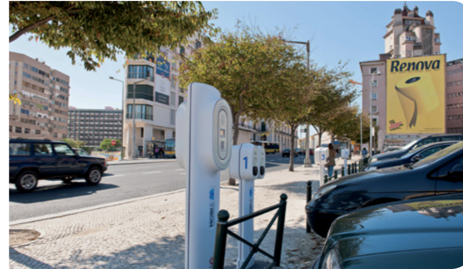
Ponto de carregamento eléctrico, Parque de Estacionamento do Areeiro
