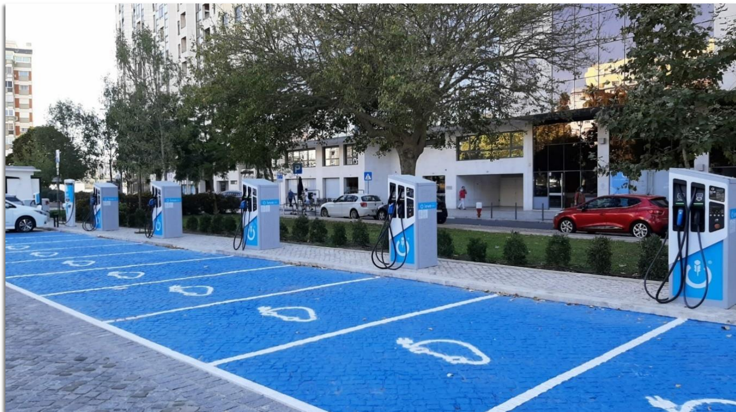
FIGURA 3-15 HUB DE CARREGAMENTO RÁPIDO DA LEVE NO CAMPO GRANDE
