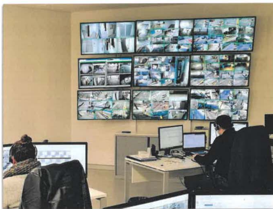
Figura 1.5 Centro de Controlo Operacional
